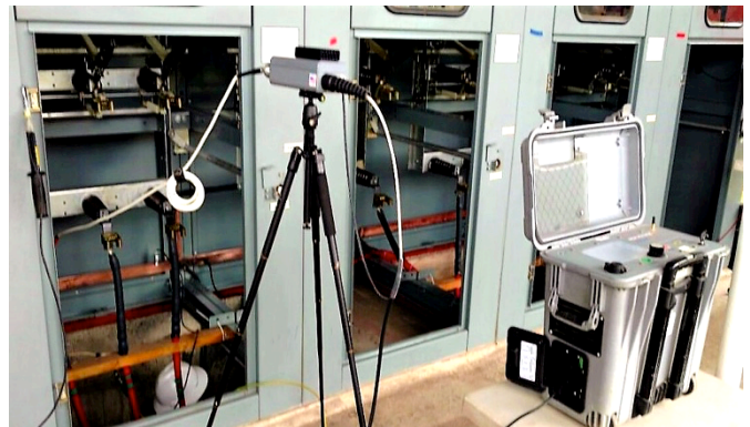
HVI VLF-34E & TD 65E testing 15kV cable
